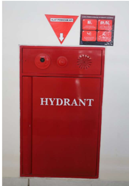
Alat Pemadam Kebakaran
